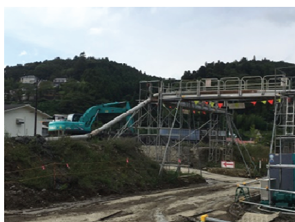
泥土供給排管
