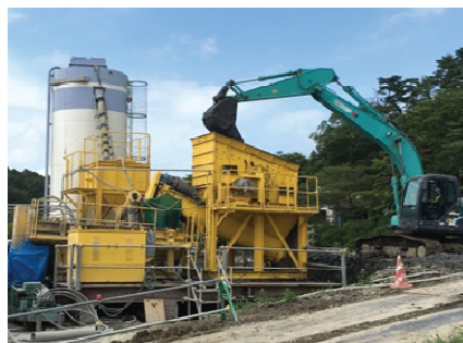
安定処理プラント（40m 3 セパレート）
