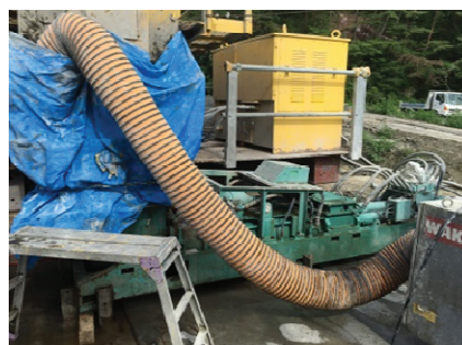
処理土圧送ユニット
