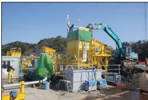
固化処理プラント
