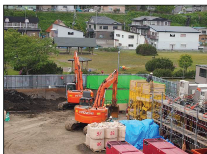
固化処理プラント
