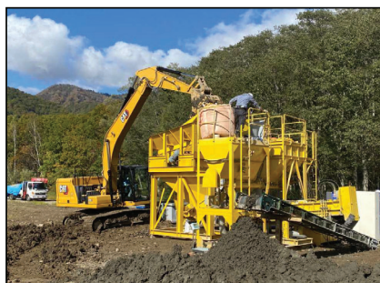
泥土再資源化装置（25m 3 セパレート
