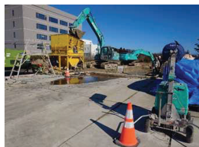
泥土供給装置
