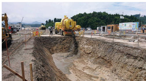
排泥-貯泥調泥処理状況
