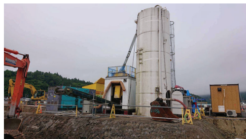
固化処理プラント
