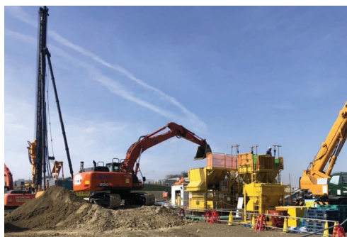
100m 3 機-排泥-貯泥調泥処理状
