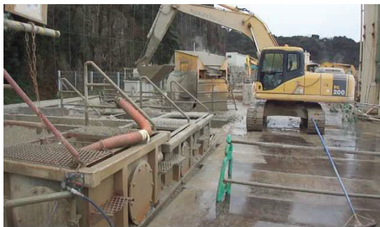
貯泥槽（水槽25m 3 ×6槽）
