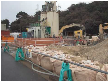
25m 3 /hユニット型処理プラント全景
