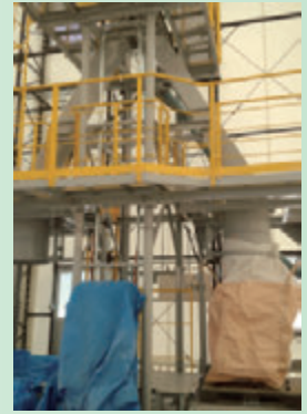
フレコンによる供給
