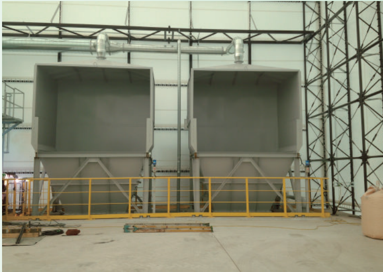
石膏粉投入装置
