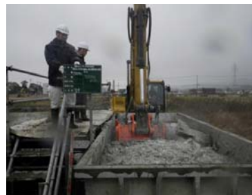
ボンファイバー攪拌状況
