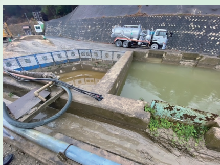
余剰水を高分子凝集剤にて沈降分離する。
