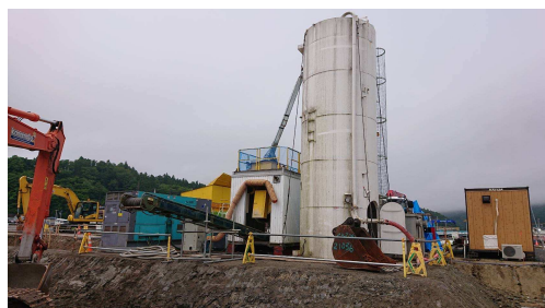
固化処理プラント
