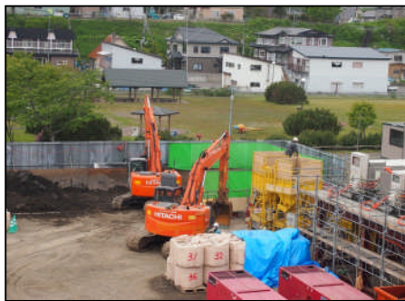
固化処理プラント
