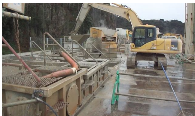
貯泥槽 (水槽25m 3 ×6槽)
