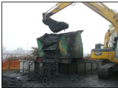
一次処理(ゴミ除去)状
