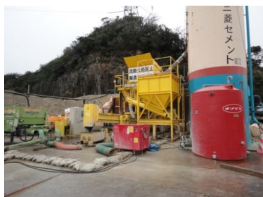
流動化処理フラント
