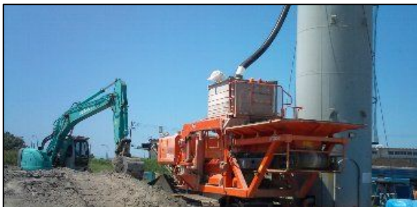
処理プラント全景
